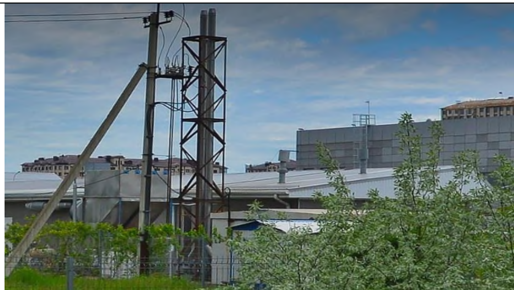
Котельная №9 - а. Новая Адыгея, ул. Тургеневское шоссе, 23
